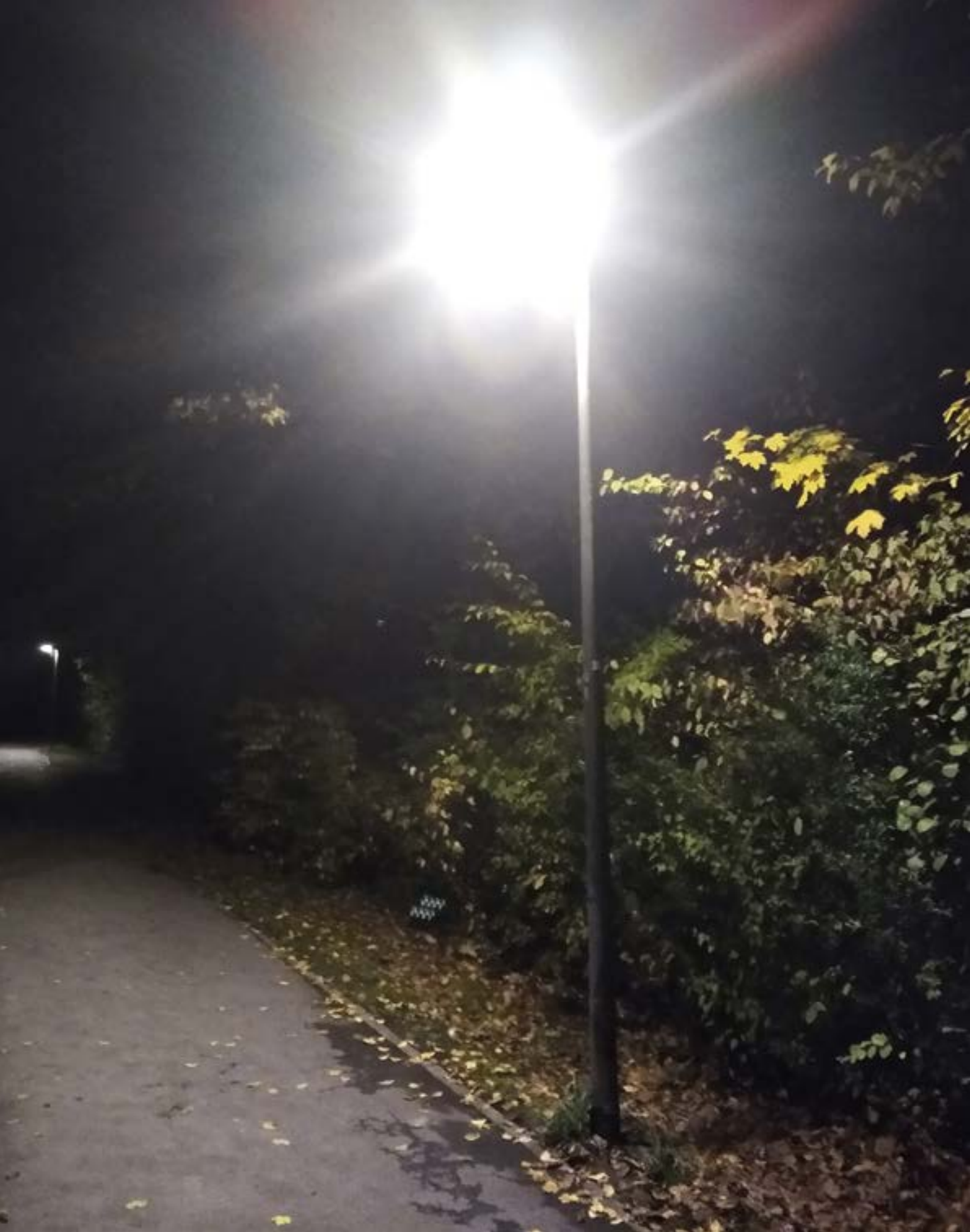
Abbildung 6: LED-Straßenbeleuchtung Gemeinde Eching (Foto: Johann Bartl, Gemeinde Eching)
